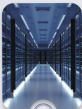
数据中心 DATA CENTER
