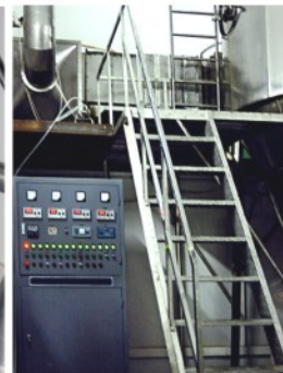
控制系统 Control System
